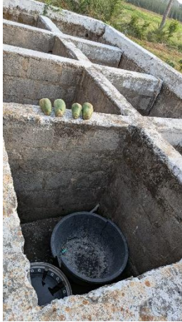
Non operational ETP
